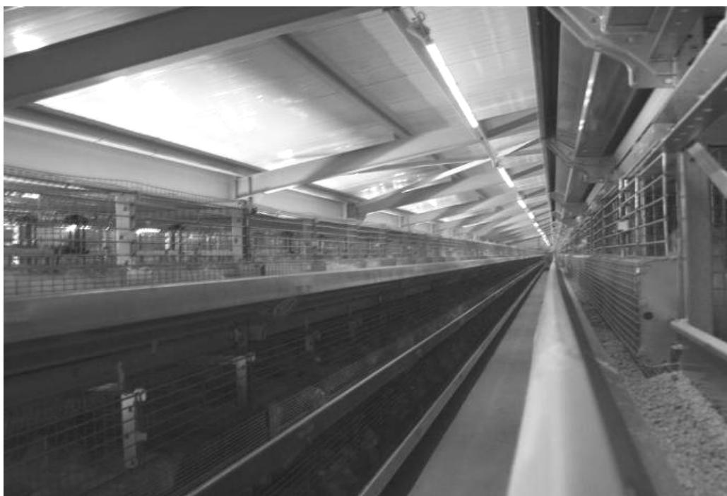
Рисунок 3 – Система освещения, выполненная линейными источниками света
