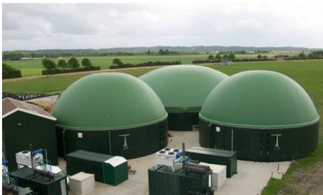
Рисунок 1 - Электростанция на биогазе. Реакторы
